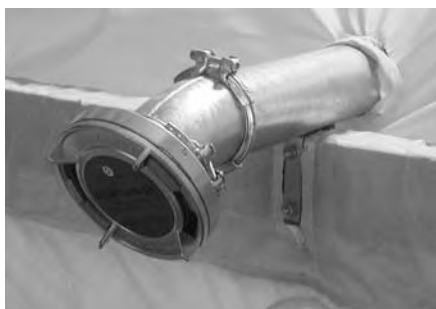
Abb.: Befestigung Befüllleitung
